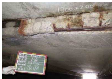
無名橋の現在の コンクリートの状態
