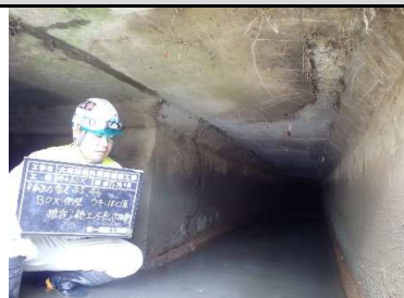
下須頃5号BOXの現在のコンクリートの状態
