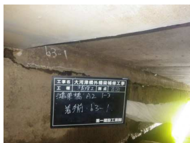
鴻巣橋の現在の ひび割れの状態
