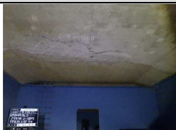
三条大橋の現在の コンクリートの状態
